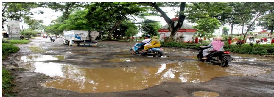
Gambar 1. Dampak banjir yang merusak jalan penghubung desa
